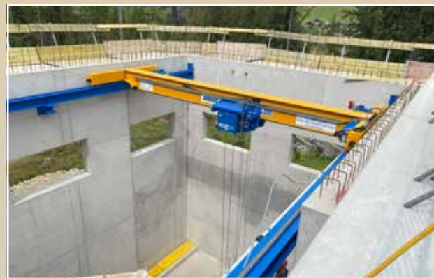
Hallenkran im Krafthaus Bruggeralmkraftwerk
